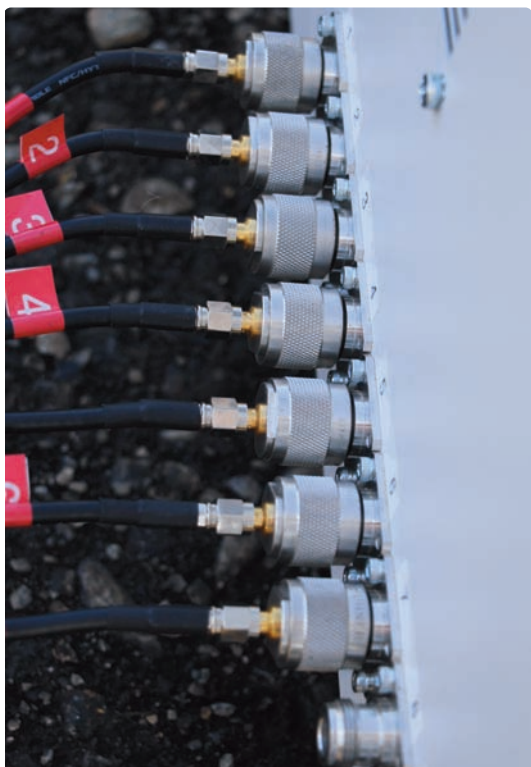
Vue des connexions des sept câbles d'antenne au rack IT. (Source: Haute école spécialisée bernoise)
